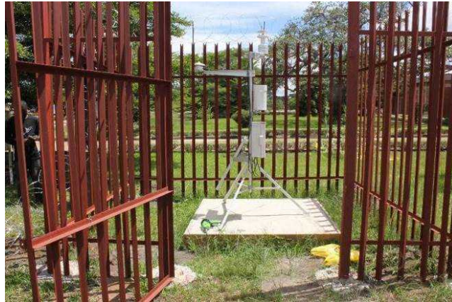
UNZA 内に設置した気象観測装置
