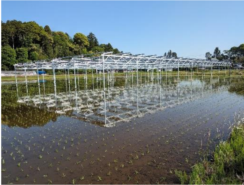
図10 新設水田ソーラーシェアリング
