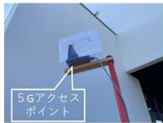
屋外設置した5G アクセスポイント
