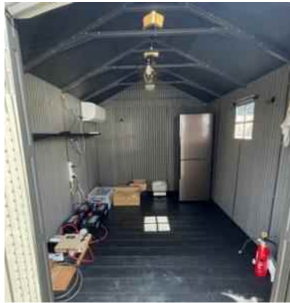
図 18 小屋の内部の状況、エアコン、冷蔵庫、ドライフードプロセッサー、自家消費関係設備が設置された
