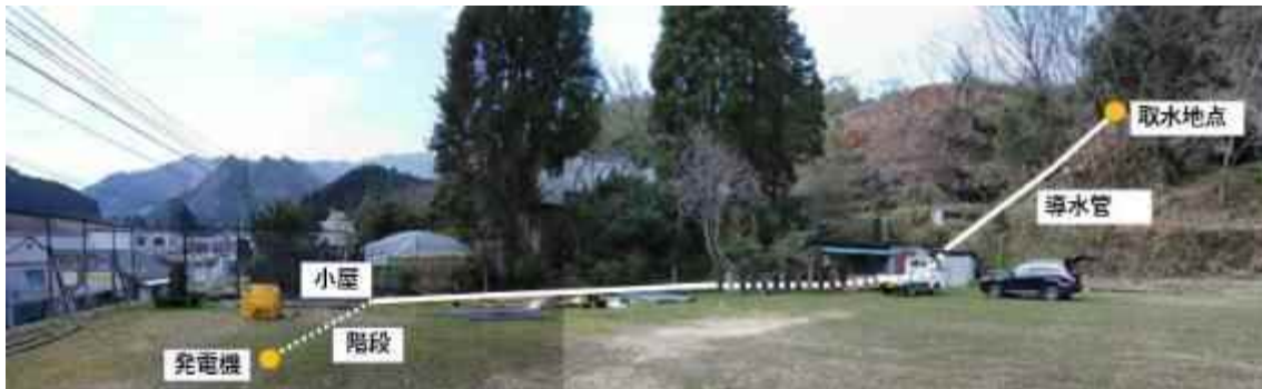
図 15 取水地点から発電機までの全体写真 発電機は階段の下に設置
