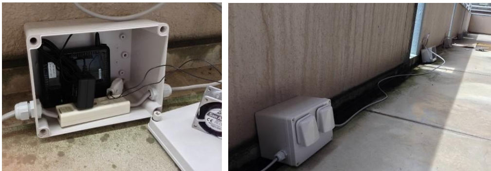
図 29 : 位置データ収集用の無線LANアクセスポイントの設置状況 (左 : 防水ケース内の無線LANアクセスポイントの収納状況、右 : ベランダへの防水ケースの設置状況)
