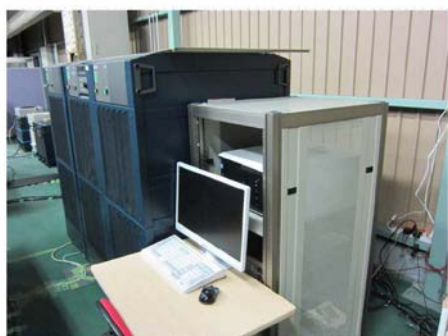
写真：模擬電力装置
