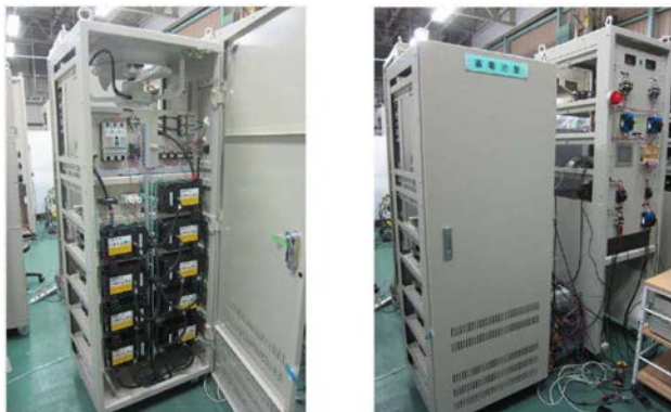
写真：蓄電装置
